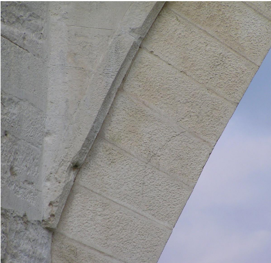
Pukotina na desnoj obali novoizgrađenog Starog mosta
