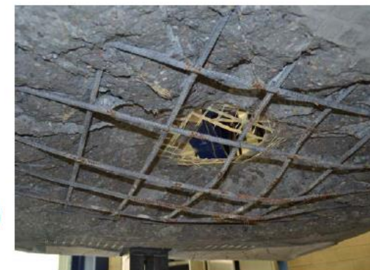
RC_2 collapse (punching cone zone)
